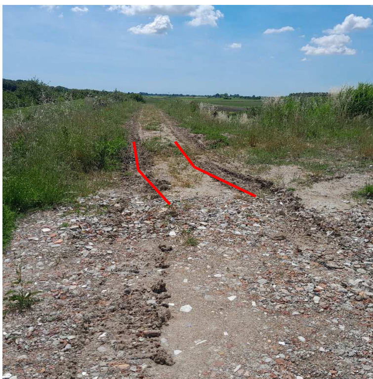
Foto 4 – Dettaglio delle ostruzioni e contropendenze per erosione/smottamento nella viabilità interna della Discarica.
