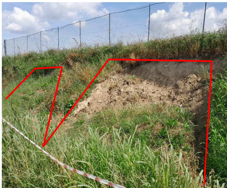
Foto 1 – Immagine della frana (scivolamento verso il basso di una porzione esterna dell'argine di contenimento) lungo l'argine perimetrale lato Bacchiglione (angolo sud-ovest).
