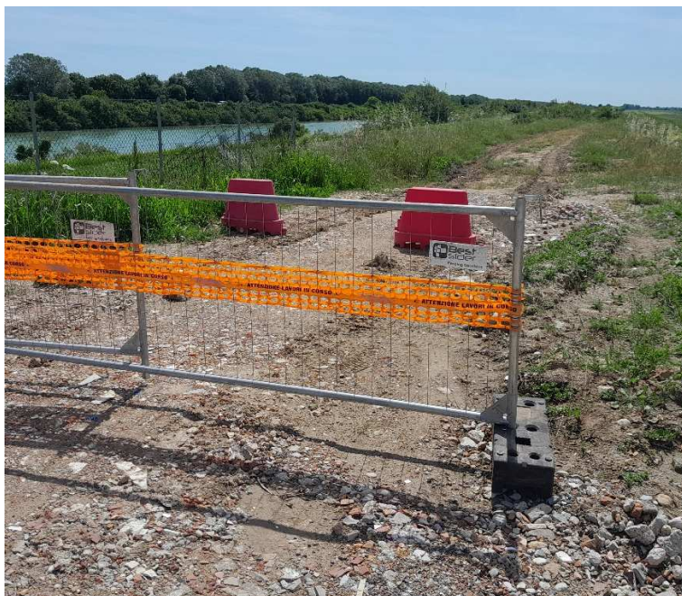
Foto 3 – Immagine di una delle ostruzioni e contropendenze per erosione/smottamento nella rete di drenaggio superficiale delle acque meteoriche che hanno in parte coinvolto la viabilità interna della Discarica.
