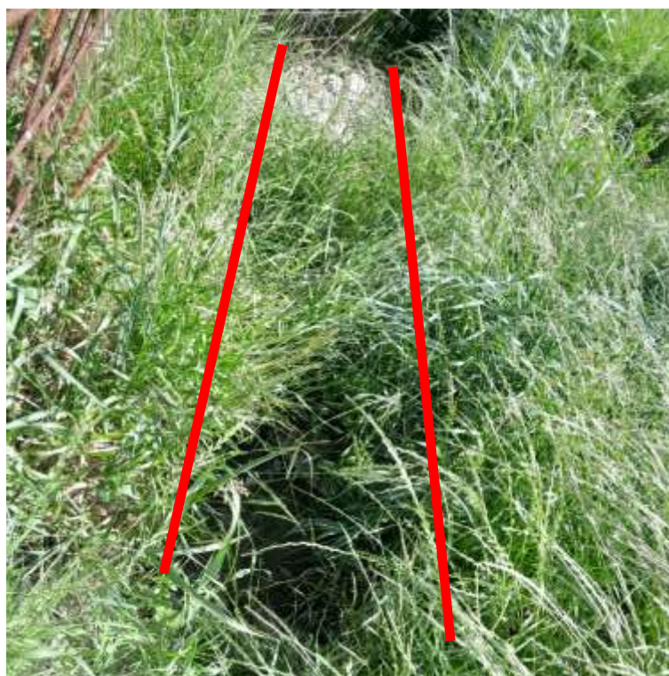
Foto 2 – Immagine di uno dei calanchi lungo l'argine e l'area perimetrale adiacente del lato Brenta (angolo nord-est) che interessa anche un tratto del diaframma in miscela di cemento e bentonite recentemente realizzato.
